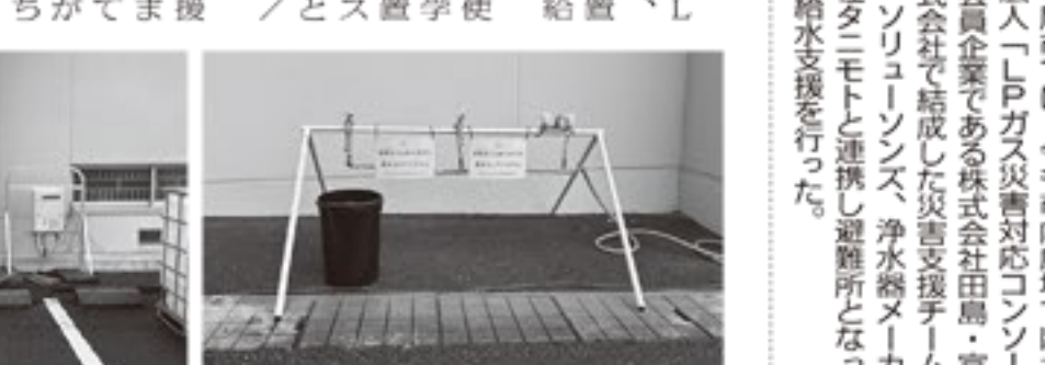
LPガス設備と給湯器、給水所を設置
