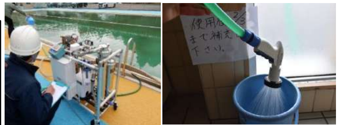
図-9 中島小学校の水源(プール)とトイレ洗浄水
